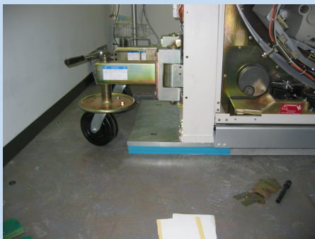
CT-Gerät mit eingebauter Lagerung
