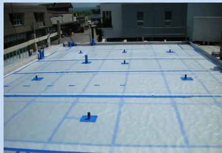
Mit PE-Folie abgedichtete Lager-Fläche mit ISODORN Erdbebensicherung und gepolsterten Leitungen. Bereit zum Einbringen der Bewehrung.
