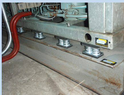
Kälteanlage auf Stahldruckfedern Typ ISOLASTIC gelagert
