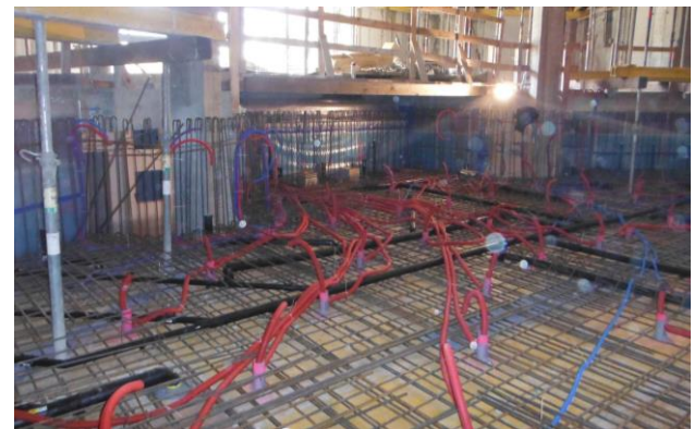
Hohe Anzahl an Rohrdurchbrüchen, welche alle entsprechend von HBT-ISOL Montageleiter elastisch getrennt werden müssen bevor die Betonplatte eingebracht wird.
