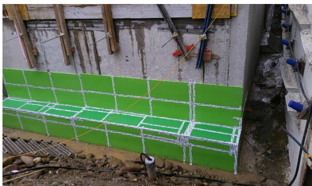
Aufbau der Lagen für die schwingungsdämmende und thermische Trennung zwischen Sauberkeitsschicht und Bodenplatte inklusive der Folie zur Feuchtigkeitssperre (gelbe Wanne).
