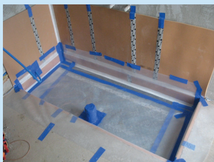
Montierte Lagerung mit geschützten und gepolsterten Zuleitung und Ablauf.
